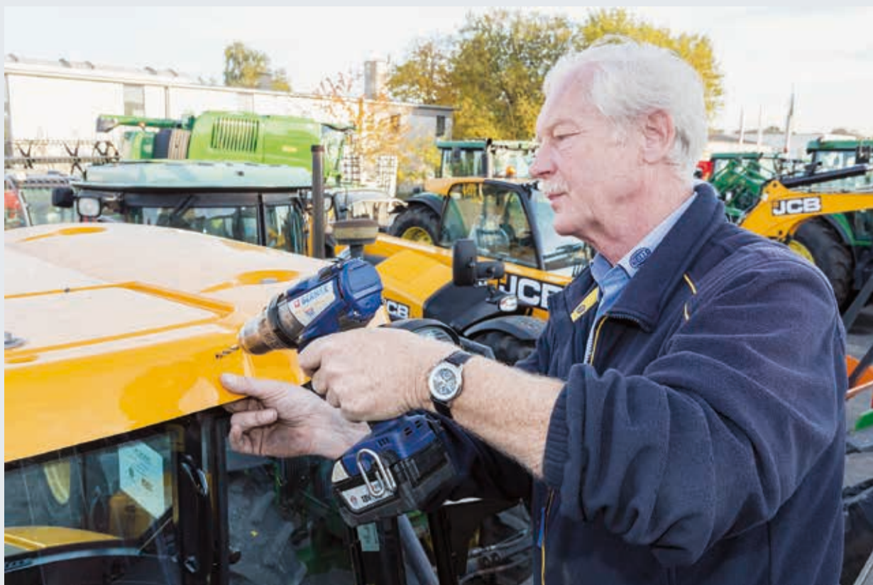
Installazione di una Light Bar nell'area del tetto: Dietmar Bengsch aziona il trapano, dopo avere preso le misure con la maschera.
